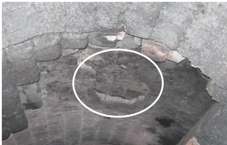
Abbildung 3-1: Schädigung des Dauerfutters in der Decke einer Torpedopfanne durch CO-Bursting. Im gekennzeichneten Bereich erkennt man bereits den Stahlmantel der Torpedopfanne.
